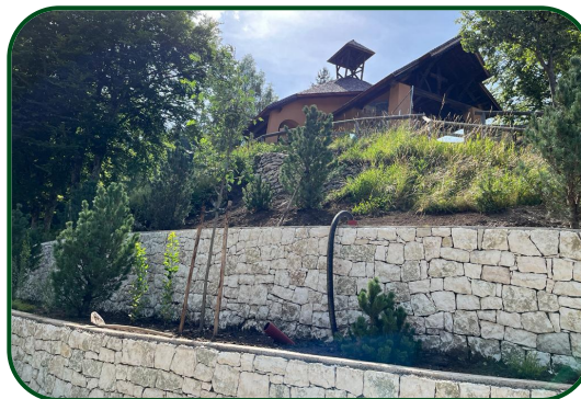
Chiesa della Madonna delle nevi sistemazione aree esterne a seguito del crollo del muro di contenimento e progetto riqualificazione interna
